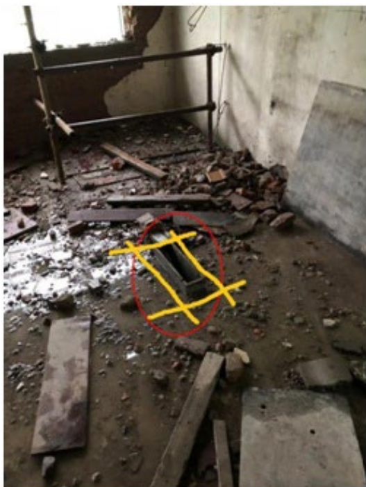
▼ 图六 尺寸不足的电气洞口
