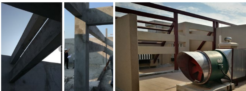
▼ 屋顶较高女儿墙的支撑梁设置不合理
