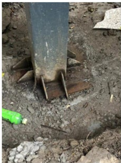
▼ 图二 跟进后锈蚀严重的柱脚
